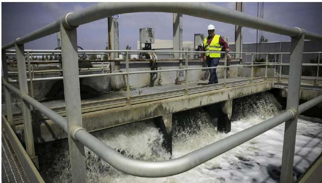
Estación Regeneradora de Agua del Baix Llobregat. / Joan Cortadellas
