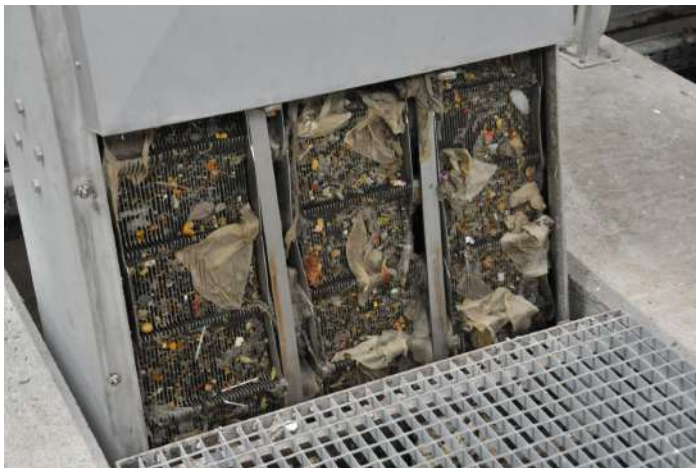
Residuos sólidos indeseados atascados en la red de saneamiento | Canal de Isabel II
